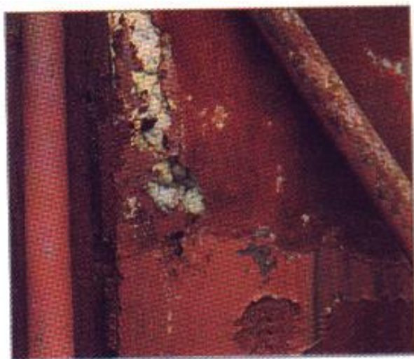
Slika 173: Korozija in totalen razpad
